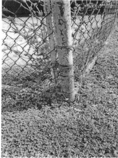
DİKMELERİN MEVCUT DURUMU
